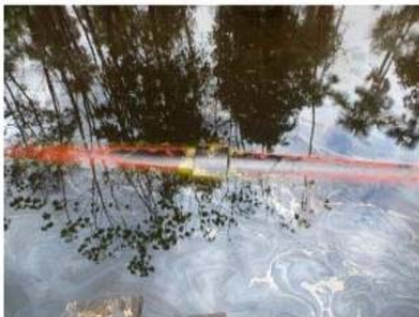
Imagen 7: Ducto Norperuano sumergido y sin soportes en Cuninico. Fuente: R. Segovia
