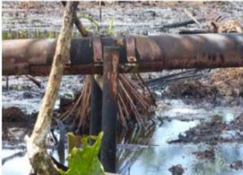
Imagen 10: Ductos con grapas y soldaduras dañadas en Pacaya Samiria. Fuente: R. Segovia
