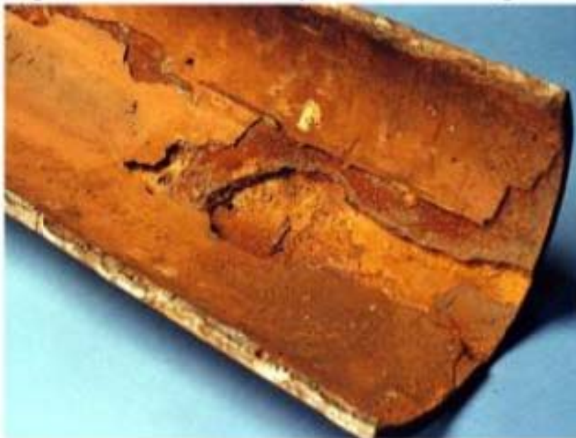
Imagen 9: Ejemplo de corrosión interna de un oleoducto. Fuente: metropolitanforensic.com
